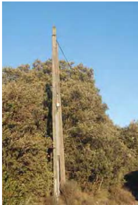
Photo 5 : Ligne électrique le long de RD 45
